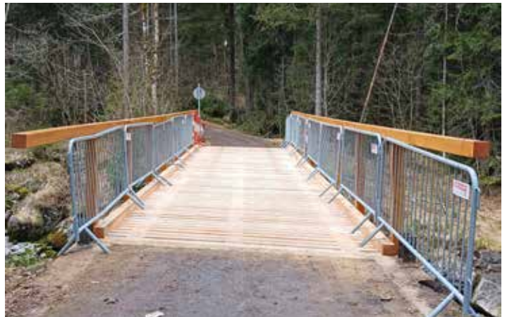
Die Arbeiten zur Sanierung der Radwegbrücken Pass Strub sind voll im Gange.
