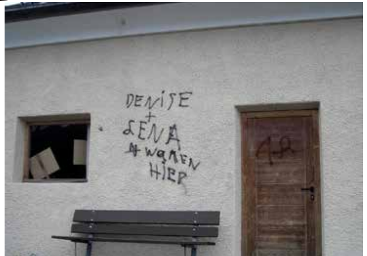
Auch das Lagergebäude am Friedhof wurde von Vandalen aufgesucht
